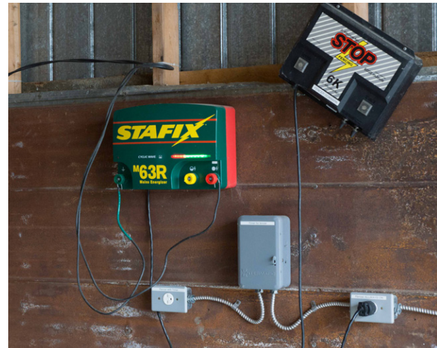
Figure 34. Installation comportant un électrificateur accompagné d'une minuterie
